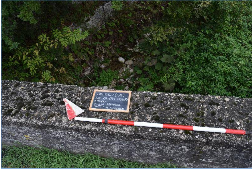
Foto n. 3: I tratto, Confluenza Vallone "Spagarino" Campo Lo piano - Ponte n. 1, particolare stato dei luoghi all'interno del vallone, dal ponte n.1.
