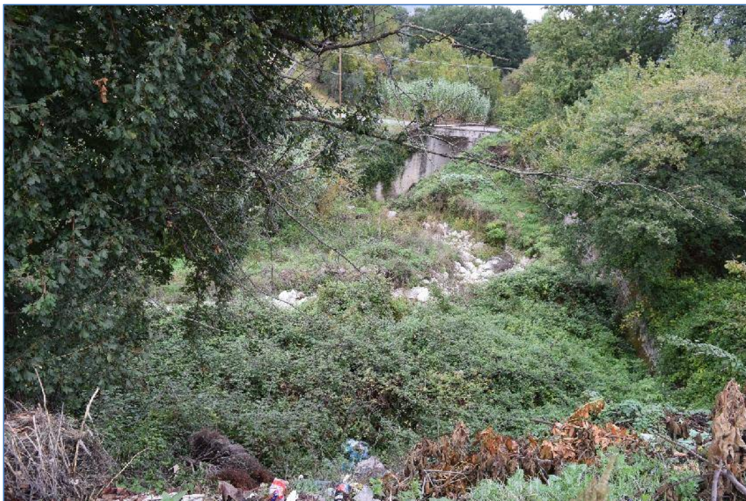
Foto n. 10: IV tratto, Ponte n.3 – Ponte n. 4 San Donato, particolare stato dei luoghi all'interno e ad immediato ridosso del vallone.
